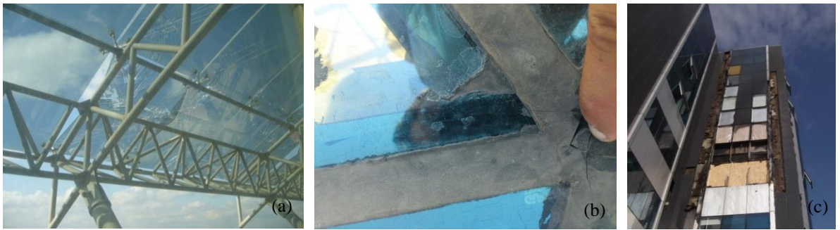
Şekil 4.5 Isıl gerilmeler nedeniyle dolgu bileşeninin kırılması (a), güneşin bozucu etkisiyle sızdırmazlık bileşeninin zarar görmesi (b), rüzgârın etkisiyle panellerin sistemden ayrılması (c)
