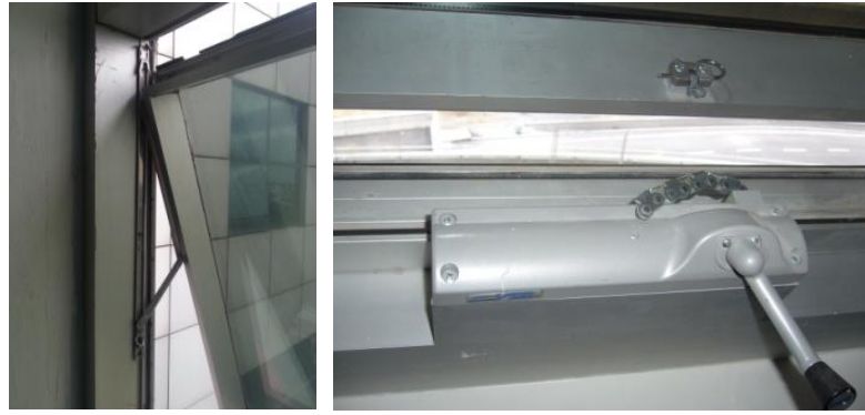
Şekil 2.2 Açılır kanat aksesuarlarında görülen hasarlar
