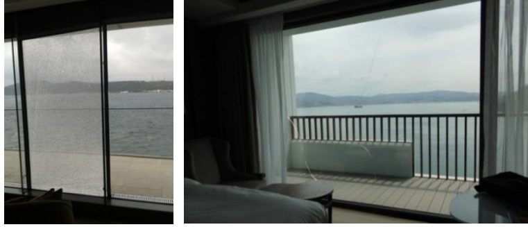
Şekil 4.3 Zemin oturması nedeniyle dolgu bileşeninde oluşan hasarlar
