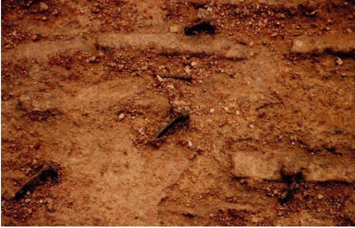
Fotoğraf 4- Tahtakale Hamamı soğukluk kubbesi dış sıvası ve sıvayı tutan çiviler
