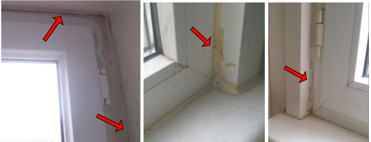
Şekil 8 İç yüzeyde hatalı detay ve uygulamalar sonucunda silikon malzeme üzerinde oluşan çatlaklar, yırtılmalar ve ayrılmalar (Fotoğraf: S. Ekinci)
