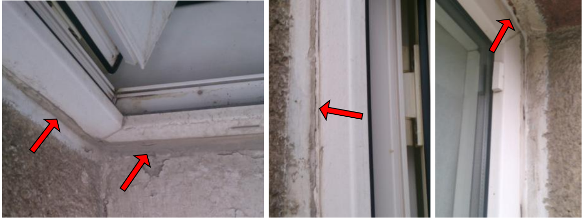
Şekil 7 Dış yüzeyde hatalı detay ve uygulamalar sonucunda silikon malzeme üzerinde oluşan çatlaklar, yırtılmalar ve ayrılmalar (Fotoğraf: S. Ekinci)
