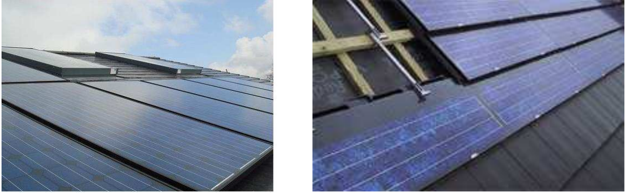
Şekil-10 Mono ve poli kristal fotovoltaik paneller ile çatı üstü kaplamalar
