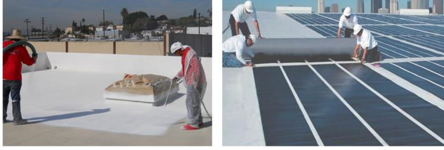
Şekil 4.2. Düşük Eğimli Çatıya Sıva Püskürtülmesi, Serin Çatı Üzerinde Fotovoltaik Güneş Panelleri Montajı.
