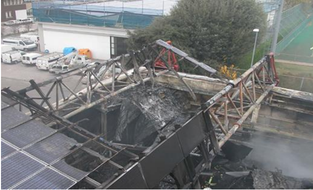
Fotoğraf 5. Fotovoltaik panellerin yanması ve yapı kabuğuna etkisi [20]
