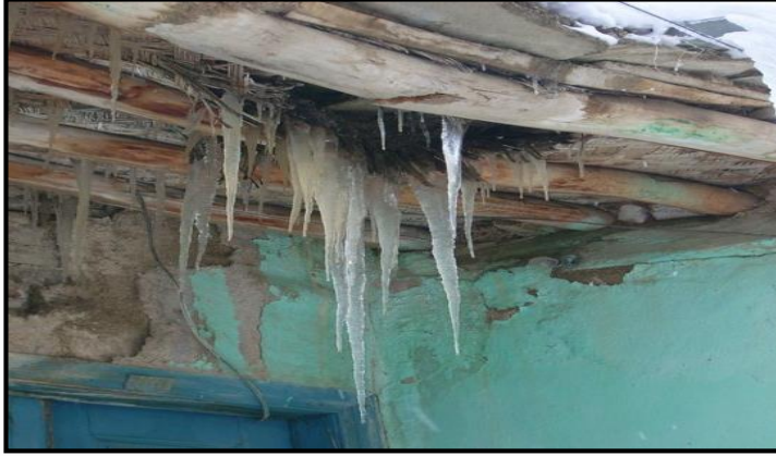
Şekil 2. Konya, Akşehir. Soğuk hava şartlarına yenilmiş bir çatı örtüsü. (Duran,S., 2012)
