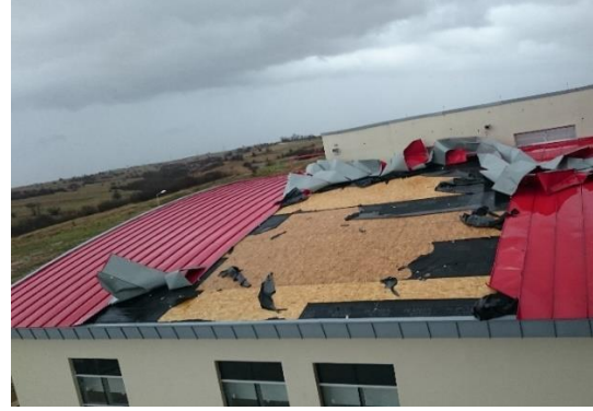
Şekil 5: Türkiye'deki bir kenetli metal kaplamada kuvvetli rüzgar kaynaklı oluşmuş hasar
