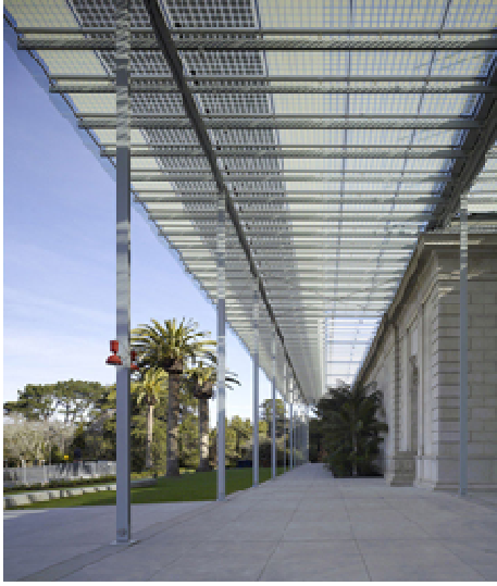
Şekil 4. Yapı saçağında bulunan PV paneller [7]
