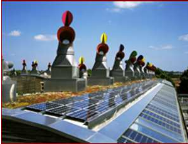
Şekil 3. PV panellerden görünüm [5]
