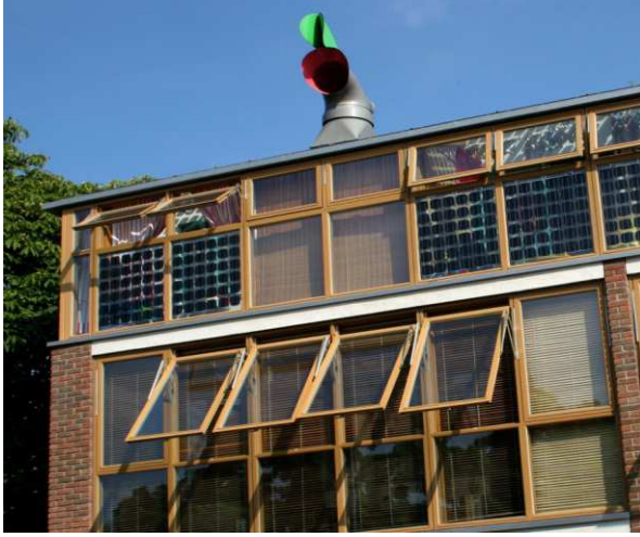
Şekil 2. Güney cephesinde elektrik enerjisi ve gölgeleme fonksiyonunu sağlayan PV hücre lamine cam uygulaması [5]
