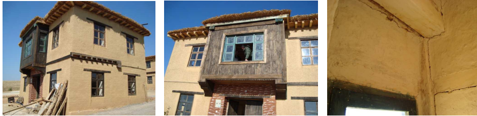
Şekil 3. Yapı cephelerindeki çıkmalar ve içerideki kısmi çatlakların görünüşü.
