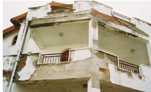
Şekil 9. Sıva malzemeleri bozulmuştur
