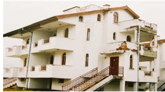
Şekil 6. Balkon sularının cephe hasarına etkisi
