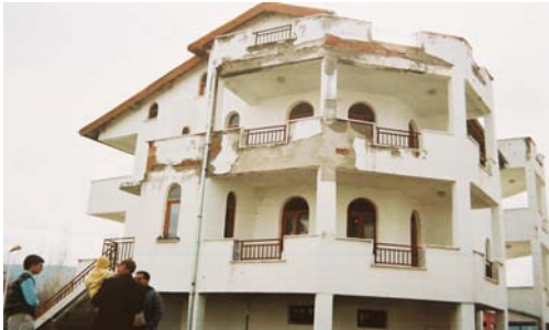
Şekil 8. Su cephe kaplamalarını bozmuştur
