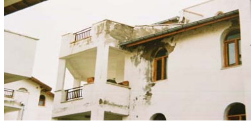
Şekil 2. Parapet ve cephede bozulmalar
