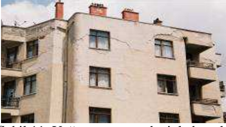
Şekil 11. Yağmur suyu nedeniyle bozulma
