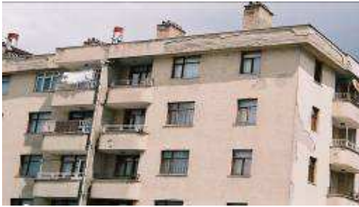
Şekil 5. Yağmur suyu cepheleri bozmuştur
