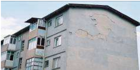
Şekil 13. Sıva ve boyalarda dökülmeler vardır
