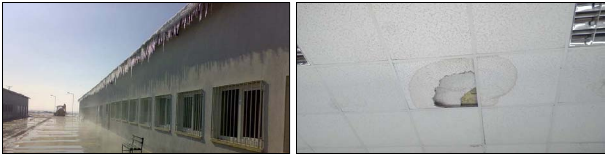
Şekil 2. Yanlış uygulama sonucu oluşan asma tavandaki tahribat ve saçaklardaki sarkıklar
