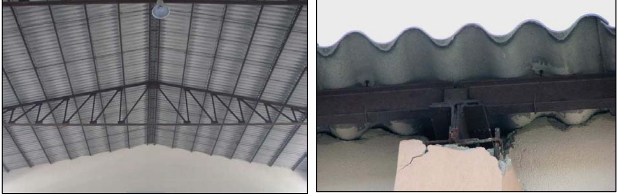
Şekil 9. İlave iç kuvvetlere bağlı yapısal hasarlar
