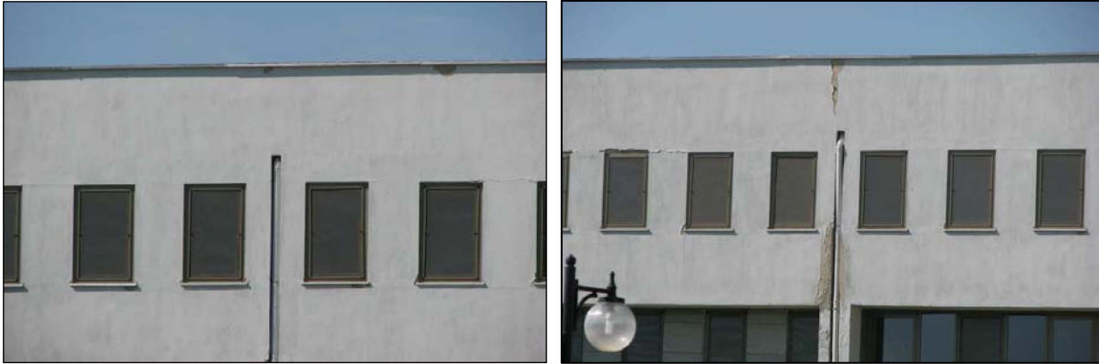
Şekil 7. Gizli oluk uygulaması ve cephede oluşan arızalar
