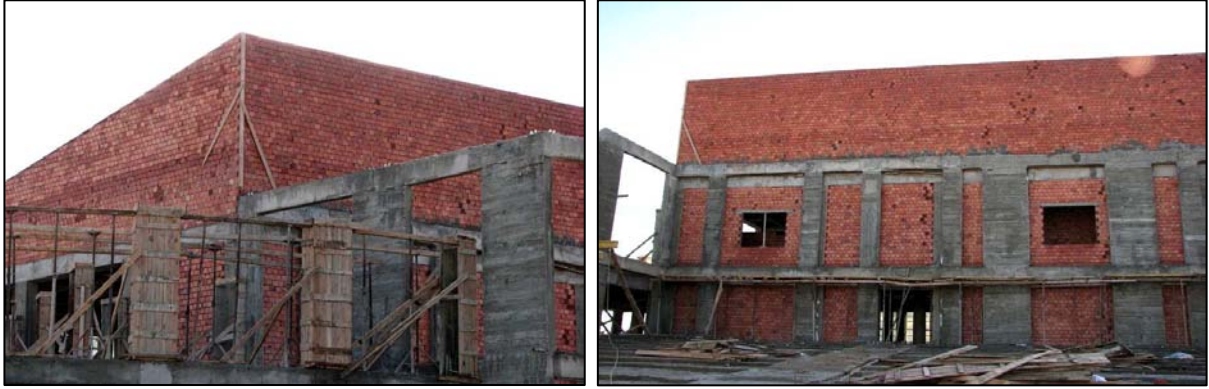
Şekil 8. Yanlış inşa edilmiş kalkan duvar örneği
