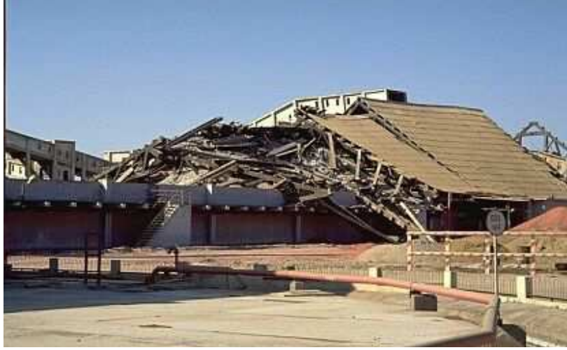
Şekil 1. Yetersiz destek durumu dolayısı ile oluşan çatı yıkımı.[5]
