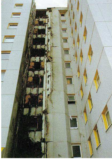
Şekil 3 Knowsley Heights, Liverpool, 1991, Cephenin geometrik yapısı nedeniyle baca etkisi oluşmuş, cephe kaplamasının yanıcılığı yangını destekleyerek üst katlara yayılmıştır. [2].
