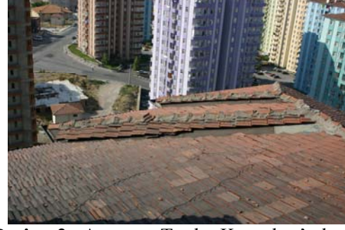
Resim 2. Anayurt Toplu Konutları'nda çatı kırılmaları
